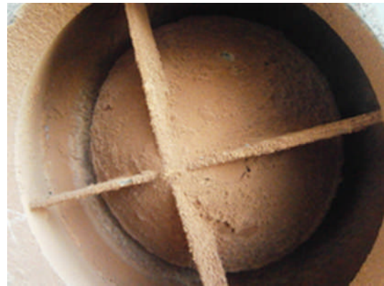
図9 修理前の消音機
